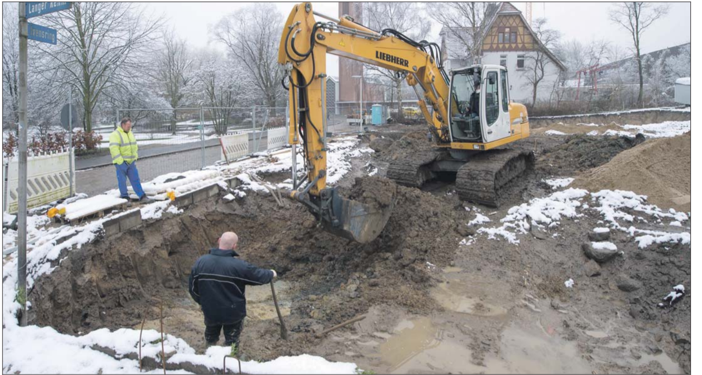
Hier entstehen 17 genossenschaftliche Wohneinheiten (davon acht mit sozialer Wohnraumförderung, neun frei finanziert) und 18 Single-Wohnungen.
